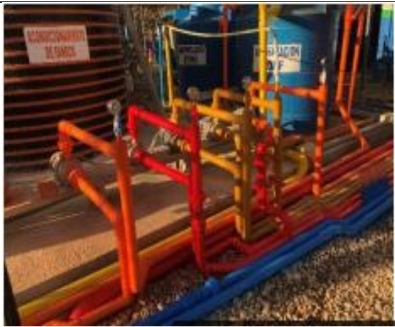
Sistema de tuberías de la PTLX
