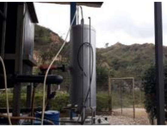
Calderín del DAF
