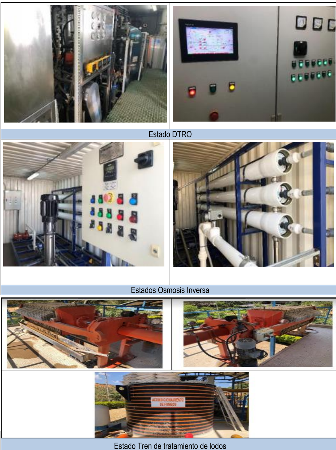
Ilustración 10. Planta de Tratamiento de lixiviados.
