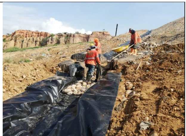
Canales superficiales de aguas lluvias
