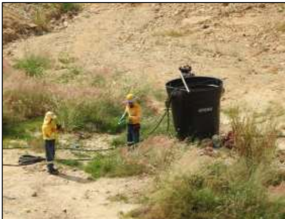
Ilustración 29 Extracción forzada de lixiviados pozos 5 celda 4.
