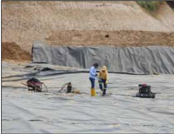
Ilustración 27 Extracción forzada de lixiviados pozos 2 celda 4.
