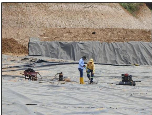
Ilustración 22 Extracción forzada de lixiviado pozo 2 celda 4.
