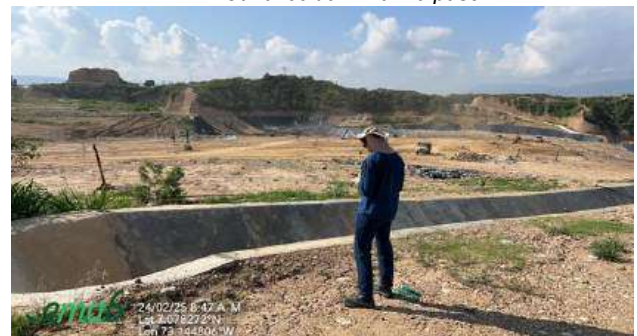
EM7- Canal 1 – Celda de Contingencia
