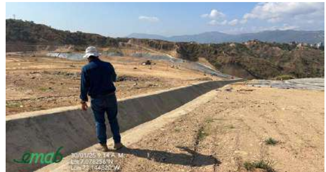
EM7- Canal 1 – Celda de Contingencia
