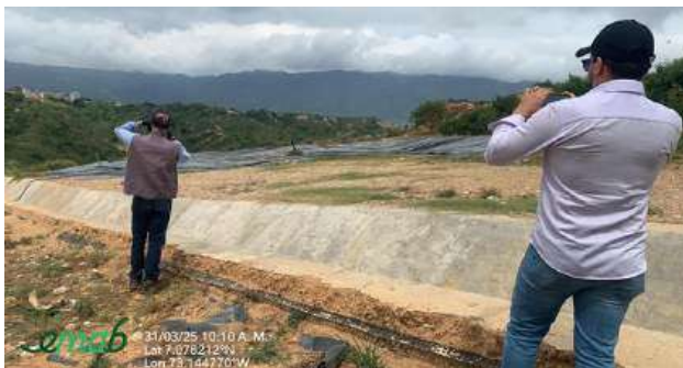
EM7- Canal 1 – Celda de Contingencia
