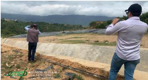
EM7- Canal 1 - Celda de Contingencia
