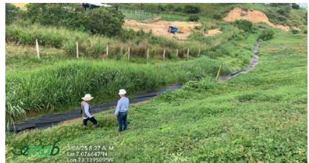
Canal celda 4 vía malpaso
