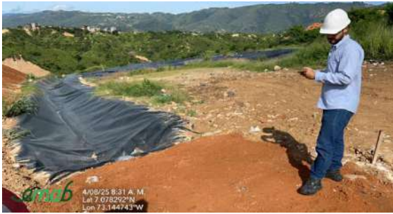
Canal 1 – Celda de Contingencia
