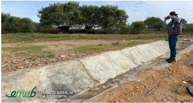
Canal 1 – Celda de Contingencia
