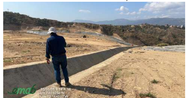
EM7- Canal 1 - Celda de Contingencia
