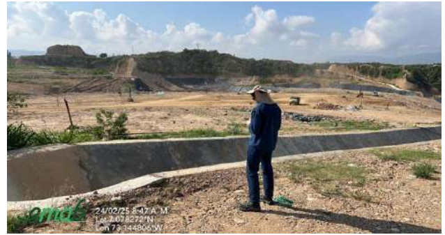
EM7- Canal 1 – Celda de Contingencia
