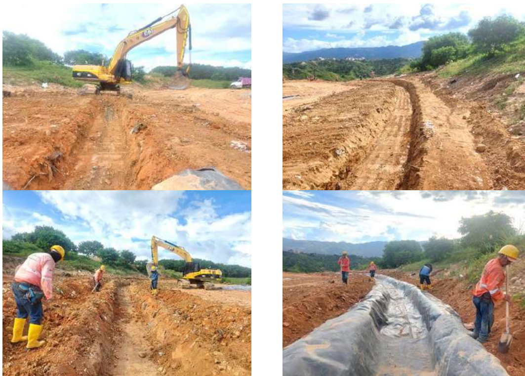
Ilustración Construcción canal superficial para manejo de aguas lluvias en el mes de agosto de 2025 Fuente: Consorcio Disposición Final, agosto 2025
