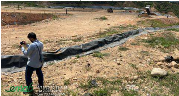
Canal 1 – Celda de Contingencia
