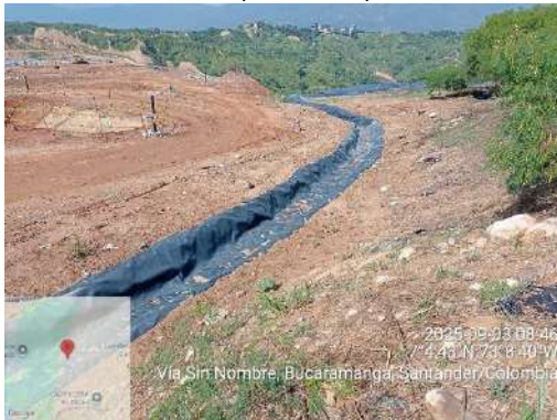
Canal 1 – Celda de Contingencia
