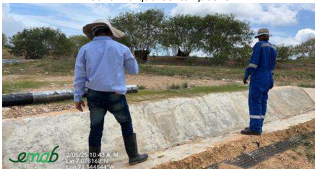
Canal 1 – Celda de Contingencia
