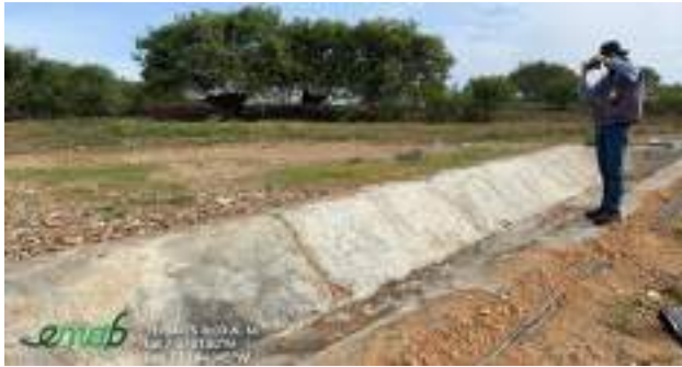
Canal 1 – Celda de Contingencia
