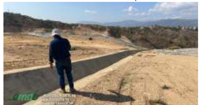
EM7- Canal 1 – Celda de Contingencia
