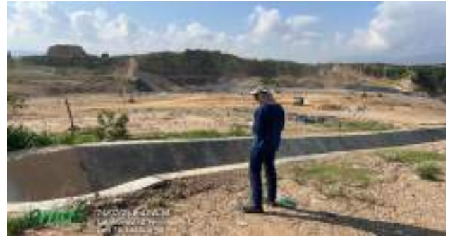
EM7- Canal 1 – Celda de Contingencia
