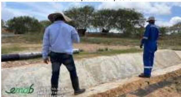
Canal 1 – Celda de Contingencia
